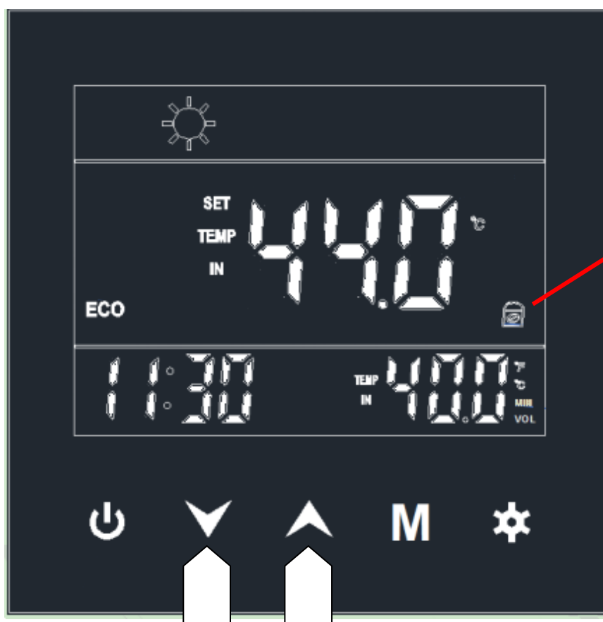
Rys. 36. Odblokowanie mikroprocesorowego sterownika pompy ciepła.
