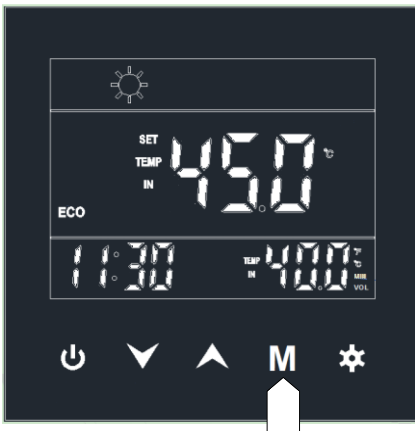
Rys. 40. Potwierdzenie nastawy temperatury wody grzewczej poprzez wciśnięcie klawisza zatwierdzenia.
