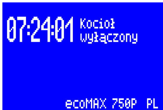
Rys. 3 Ekran regulatora przy wyłączonym kotle
